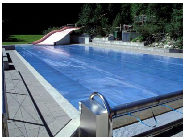
Illustration 25 Couverture de bassin d'une piscine publique
